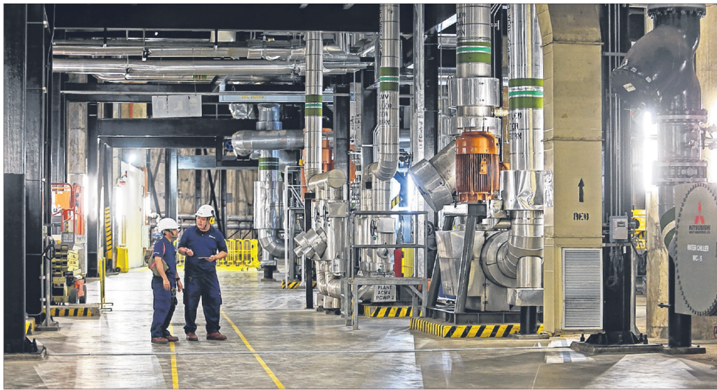
区域冷却系统能集中制造和输送冷水，它协助大楼业者节省了超过四成的能源成本。图为滨海湾地底区域冷却系统的其中一个制冷厂。（档案照片）
