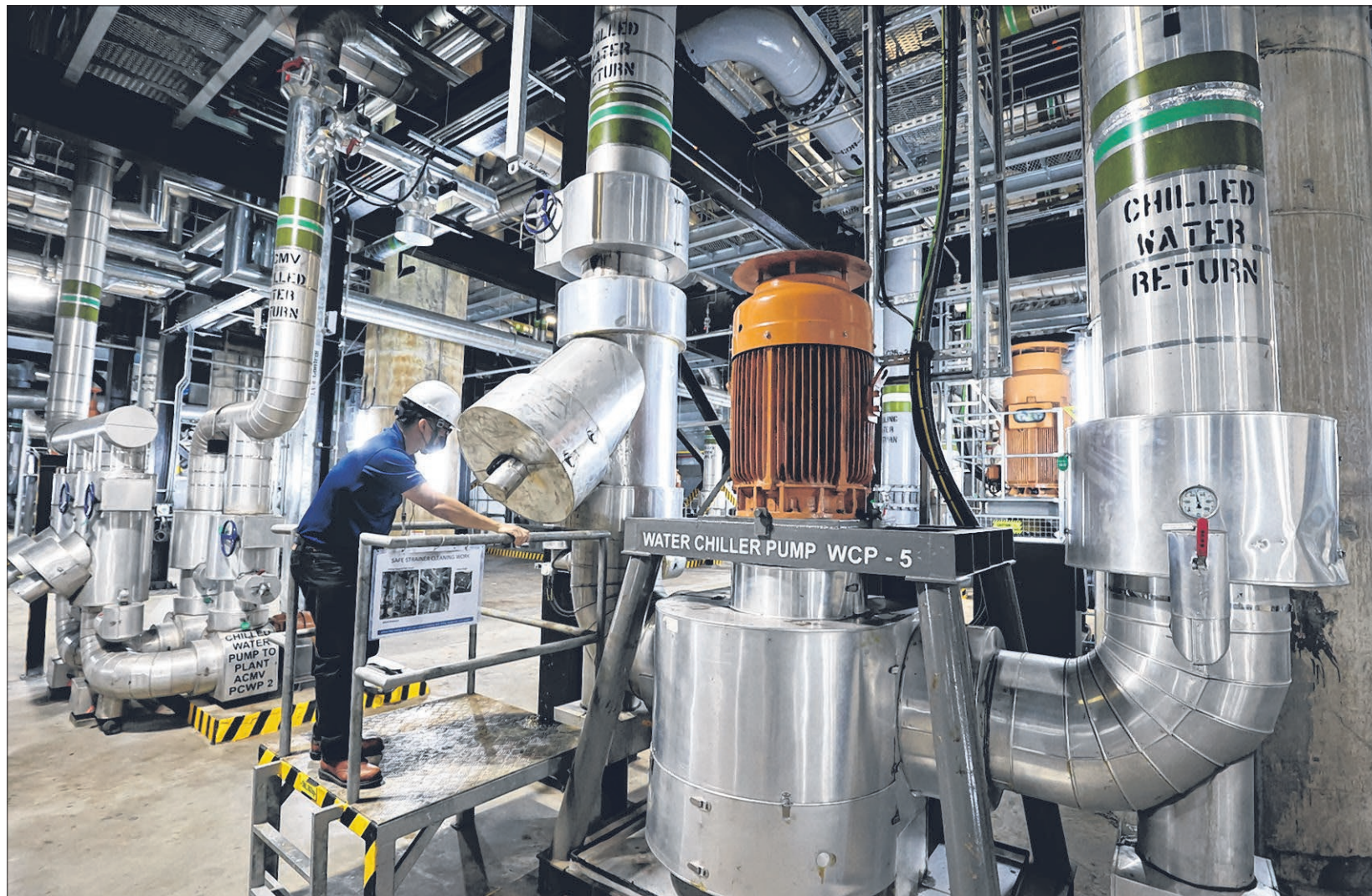
滨海湾区域供冷网的第二个制冷装置位于滨海湾金沙地下，这里的储热箱长期储存冰块，可在电费高涨或冷却设施出问题时代时释放冷却水到供冷网，提高系统的韧性。（梁麒麟摄）
