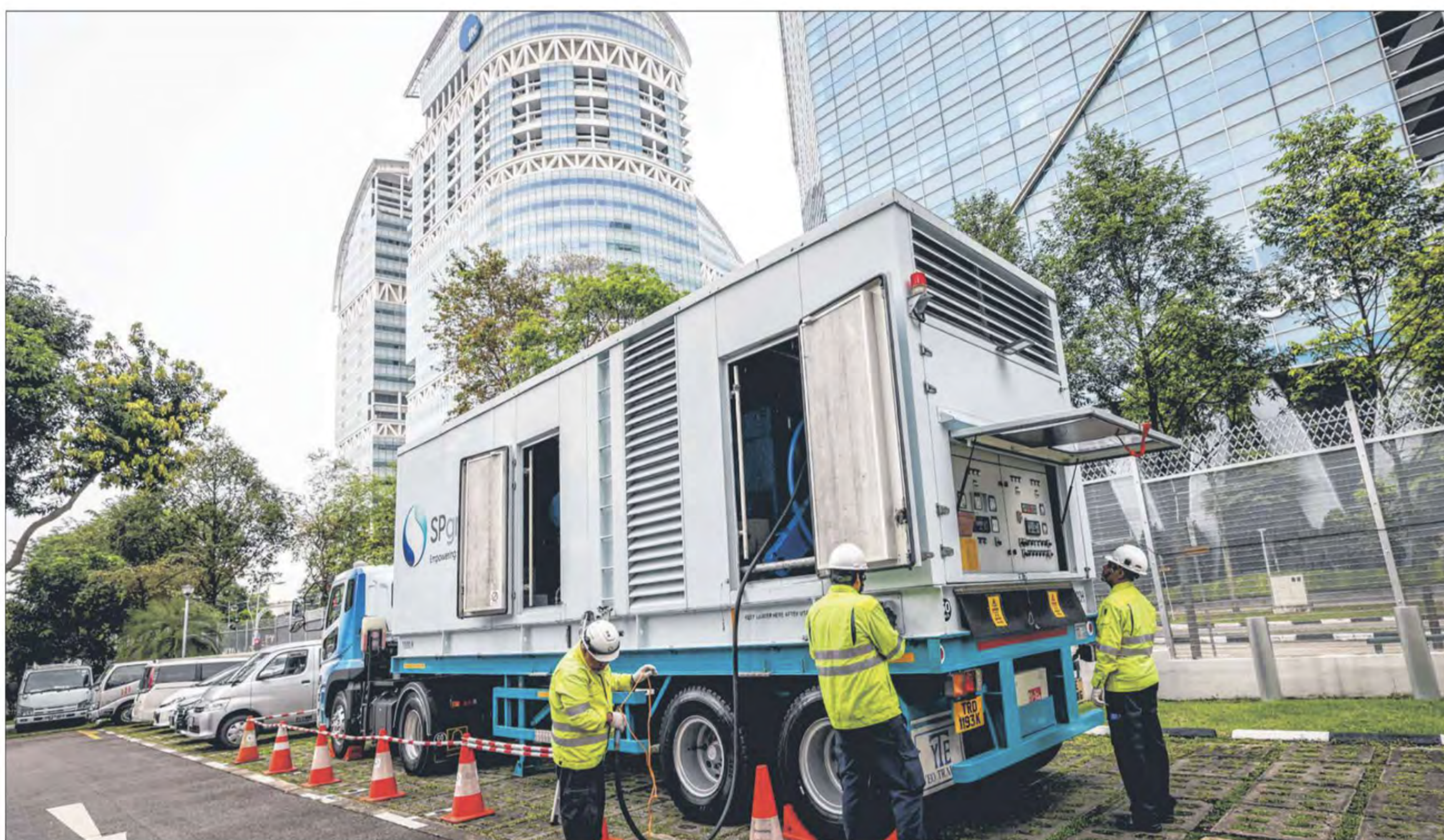
新能源集团会调派这类移动式发电机参与新加坡齐心应变演习。从出动到设置，它可以在两个小时内，开始为受影响的地区供电，每次充电可满足400个组屋单位八个小时的电力需求。（叶振志摄）
