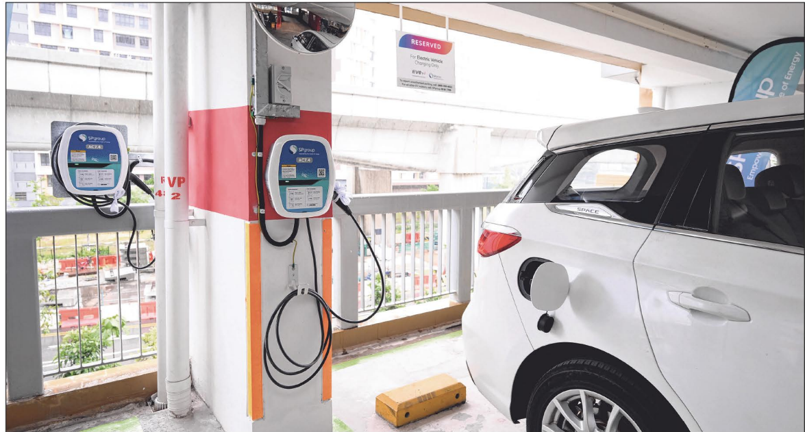
Enam pengecas kenderaan elektrik (EV) yang baru dipasang terletak di lot 250, 251, 252, 265, 266 dan 267 di tempat letak kereta bertingkat (MSCP) Blok 112, Plantation Crescent, Tengah. – Foto ST
