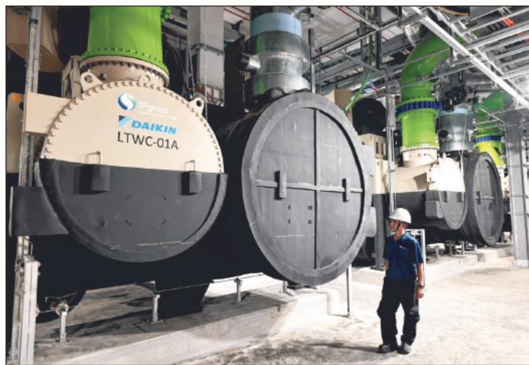
区域供冷系统通过中央制冷厂统一生产和输送冷冻水，为多座建筑集中供冷，提高能源使用效率，并降低运营成本。图为设于宏茂桥科技园的新加坡最大工业区域供冷系统。（周国威摄）
