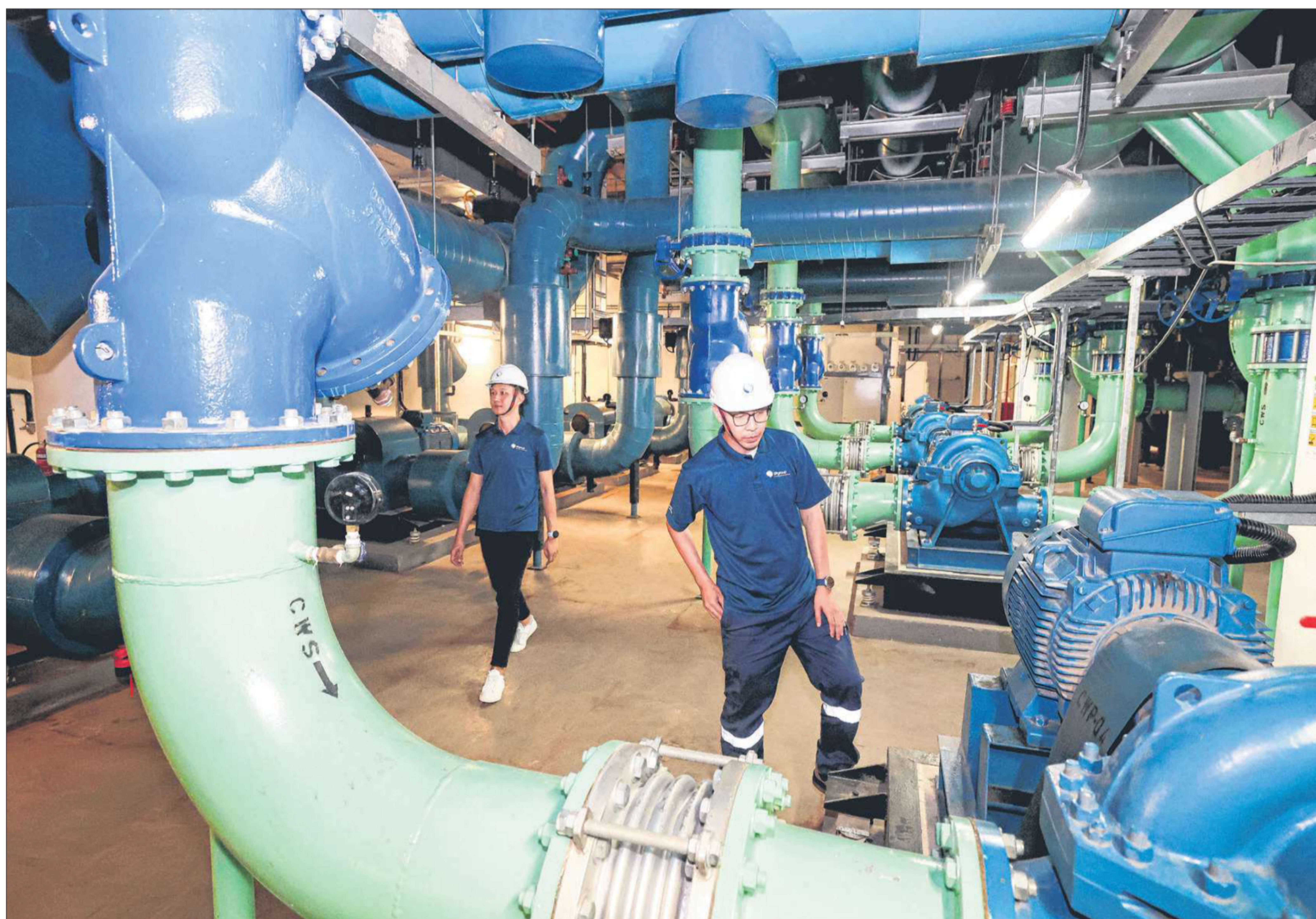
新能源集团在淡滨尼天地等三处供冷站加装了泵设备，建筑原有的制冷机提供的冷冻水不仅可满足自身建筑需求，还可通过新增泵设备和地下管道输送到供冷网络的其他建筑。（李冠卫摄）
