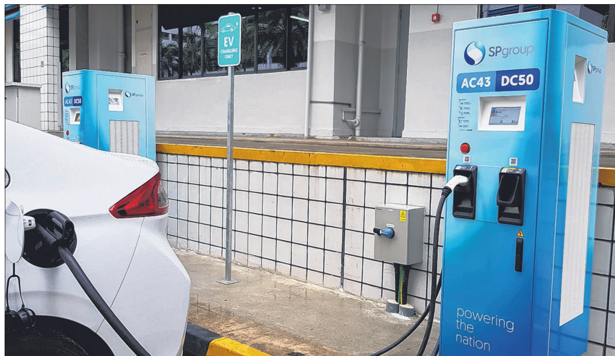
新能源集团在全岛多个地点提供电动车充电设备，这些采用直流电和交流电充电器的设备可让电动车更快完成充电。（海峡时报）
